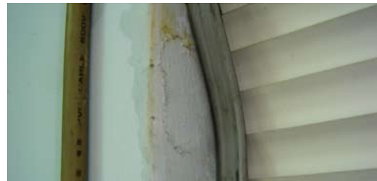
注意牆角、窗框的牆面，是否有水漬
